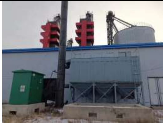
热风炉除尘器及烘干塔照片
